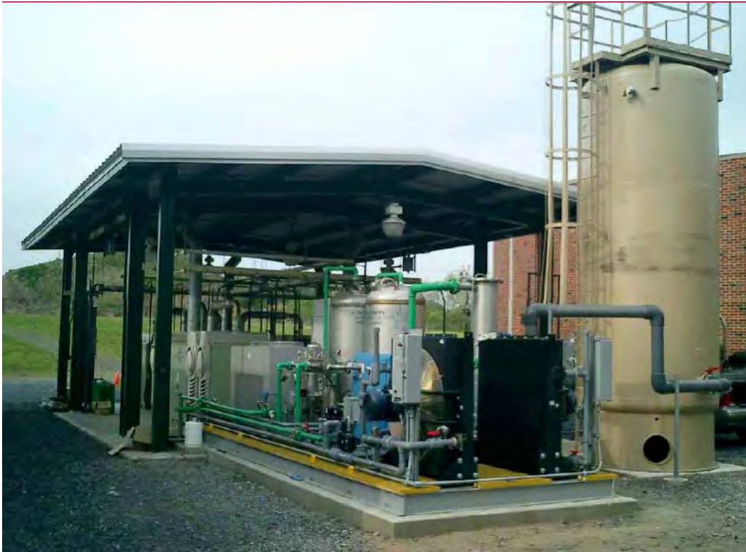
Рисунок 3-5. Відкрита установка у складі мікротурбін Capstone і блоку очистки газу
