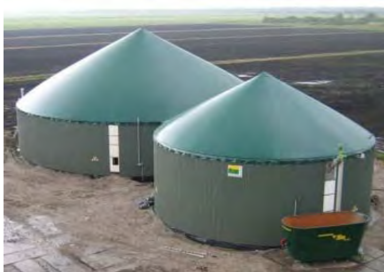
Рисунок 3-9. Реактори повного перемішування – установка потужністю 526 кВт (матеріали компанії Biogas Nord)
