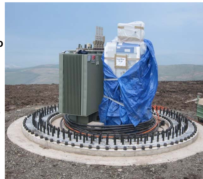
Основа турбины и трансформатор (Фото: Пол Андерсон)
